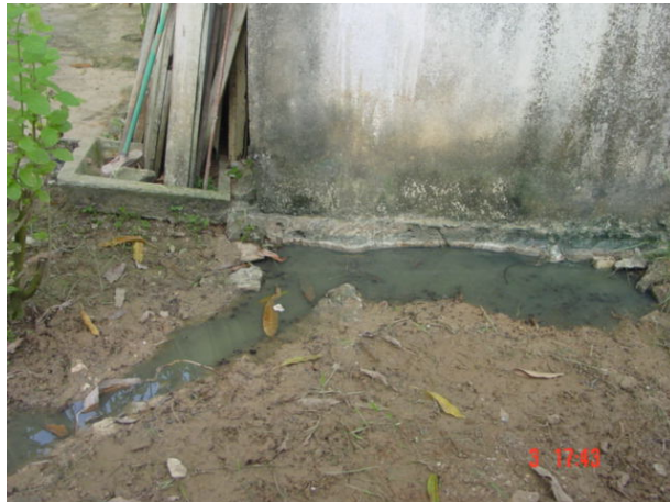
Fotografía No 10: Fotografía Pozo séptico realizando vertimientos superficiales
